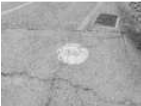
Imatge 8. Senyalització horitzontal de limitació de velocitat en mal estat al carrer de la Creu.
